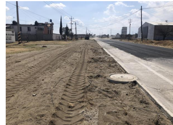
OBRA TERMINADA, POZO DE VISITA PARA VENTILACION Y MANTENIMIENTO DE LA LINEA DEL SUBCOLECTOR
