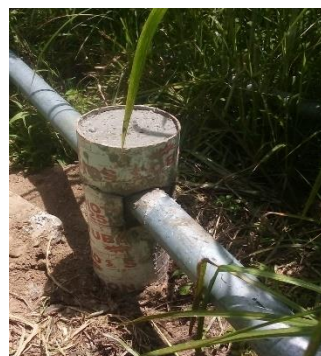
OBRA EN SU ETAPA FINAL, CON LA REHABILITACIÓN DE LA LÍNEA DE CONDUCCIÓN A PARTIR DE LA CAPTACIÓN
