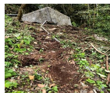
CAJA DE CAPTACIÓN
