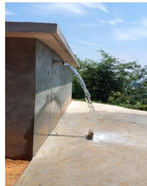
TANQUE DE REGULARIZACIÓN DE CONCRETO
