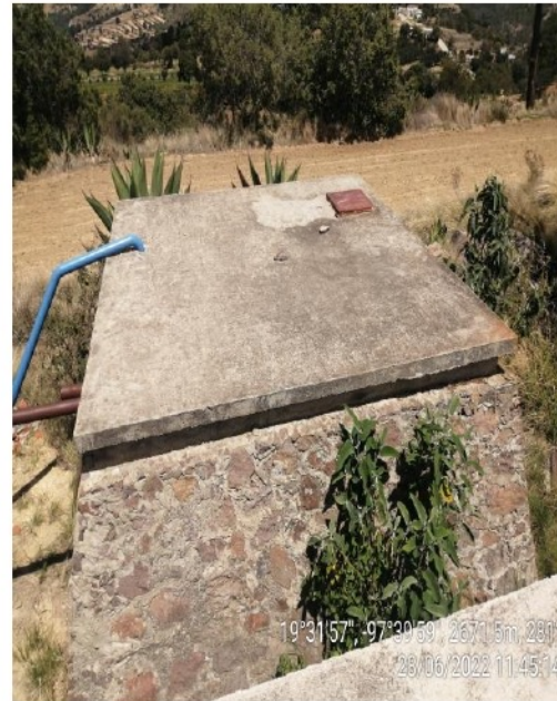
TANQUE DE ALMACENAMIENTO Y DISTRIBUCIÓN DE AGUA POTABLE
