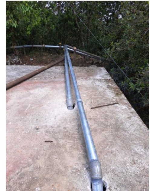
TUBERIA DE LLEGADA AL TANQUE
