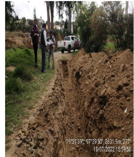
TRABAJOS DE VERIFICACIÓN DE TRAZO Y EXCAVACIÓN EN ZANJA PARA LA COLOCACIÓN DE TUBOS DE PVC RD-26 DE 51 MM
