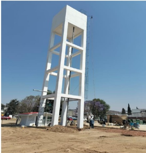
TANQUE ELEVADO CON CAPACIDAD DE 50 M3
