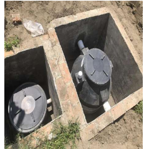
SISTEMA DE TRATAMIENTO, SUMINISTRO E INSTALACIÓN DE EQUIPOS, REGISTRO DE LODOS Y BIODIGESTOR
