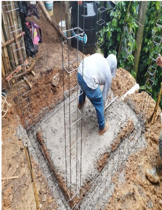
EXCAVACIÓN, PLANTILLA, COLADO DE DADOS, PARA DESPLANTE DE CADENAS Y COLADO DE PISO
