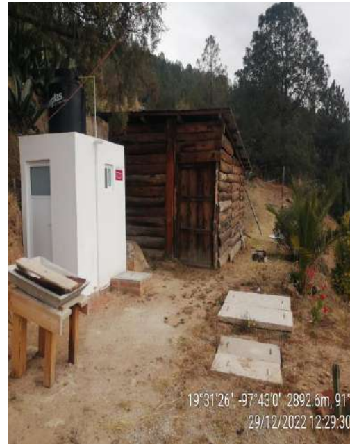
VISTA GENERAL DE TRABAJOS TERMINADOS DE BAÑO, REGISTROS, CANCELERÍA Y TANQUE DE 450 LITROS.
