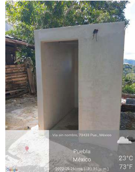
CONSTRUCCIÓN DE CASETA, REPELLADO DE MUROS Y EMBOQUILLADO DE PUERTA Y VENTANA.
