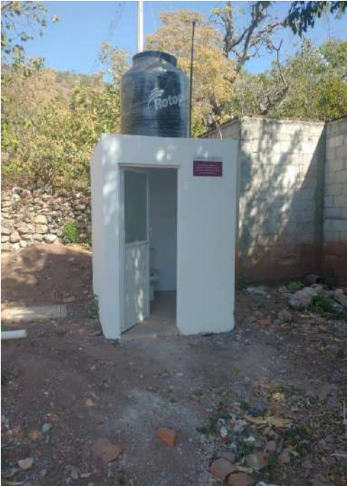
BAÑO A BASE DE BIODIGESTOR
