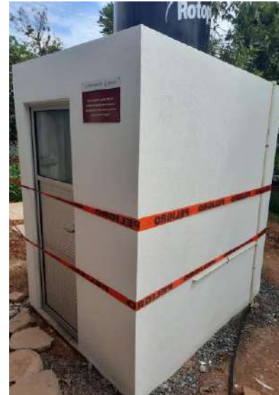
ACCIÓN TERMINADA CON SU PUERTA DE ALUMINIO Y PLACA DE IDENTIFICACIÓN
