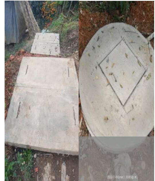
CONSTRUCCIÓN DE REGISTRO DE BIODIGESTOR, DE LODOS Y POZO DE ABSORCIÓN TERMINADOS
