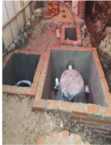
CONSTRUCCIÓN DE REGISTRO DE INSPECCIÓN DE BIODIGESTORES, LODOS Y POZO DE ABSORCIÓN
