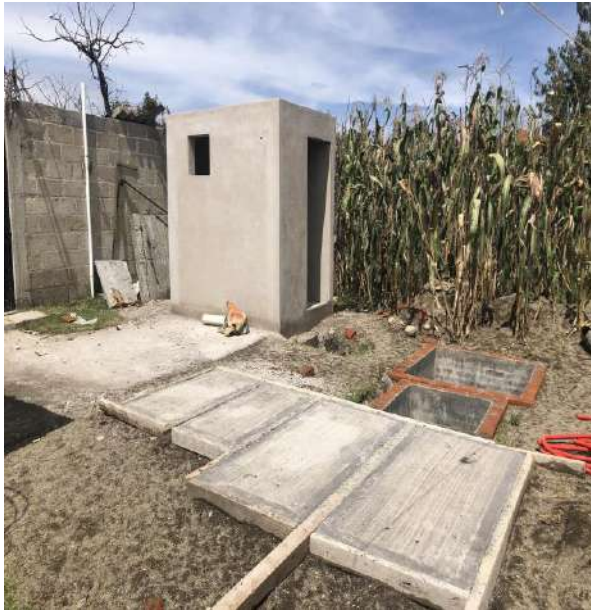
REGISTRO SANITARIO Y DEPOSITO DE LODOS CON TAPAS DE CONCRETO.
