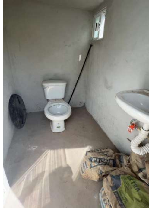
EQUIPAMIENTO DE W.C. Y LAVABO EN LA CASETA
