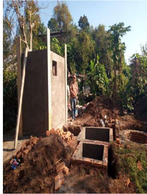
EXCAVACIONES, CONSTRUCCIÓN DE BAÑO Y REGISTROS PARA BIODIGESTORES, LODOS Y POZO DE ABSORCIÓN.
